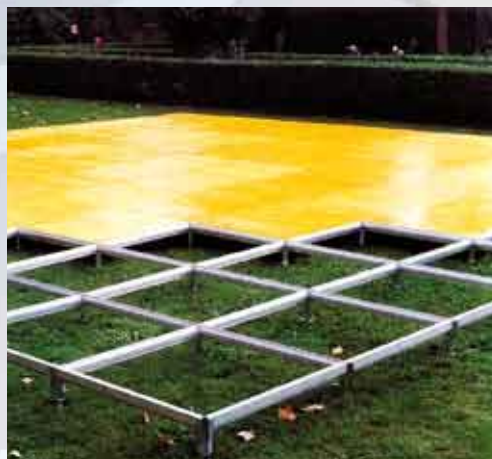
Pedana alluminio in fase di montaggio Castello di Nelson - Bronte (CT) Aluminium board during the assemblage Castello di Nelson - Bronte (CT)
